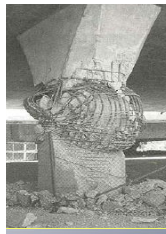
شکست برشی ستون طی زلزله 1994 نورتریج
