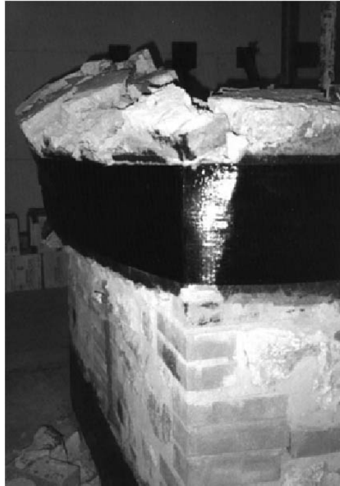
شکل ۲: کارآیی لایه ی کامپوزیتهای پایه پلیمری (FRP) تا فرو ریختن دیوارهای آجری
